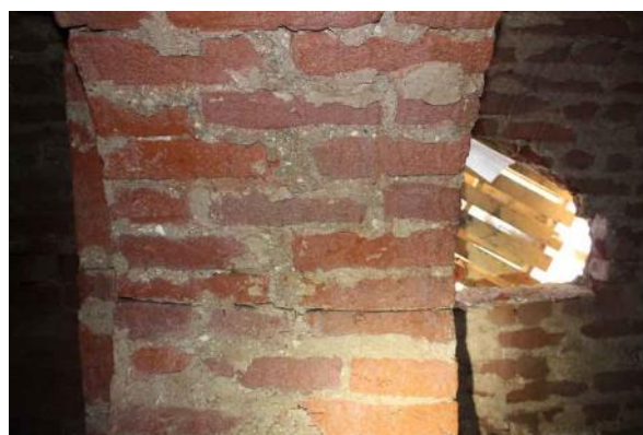
Fig. 89. Evidenti fratture riportate dall'arco di rinforzo della volta della Galleria delle Radici.
