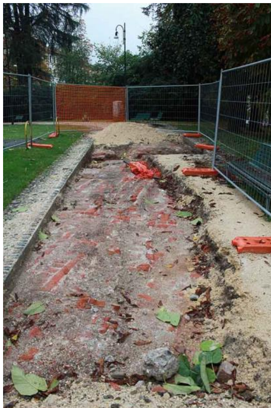
Fig. 78. 2019: la ruspa ha grattato via la poca terra che copriva la cimata Ghirlanda provocando dei danni alle sottostanti architetture, ovvero alla Galleria delle Radici.
