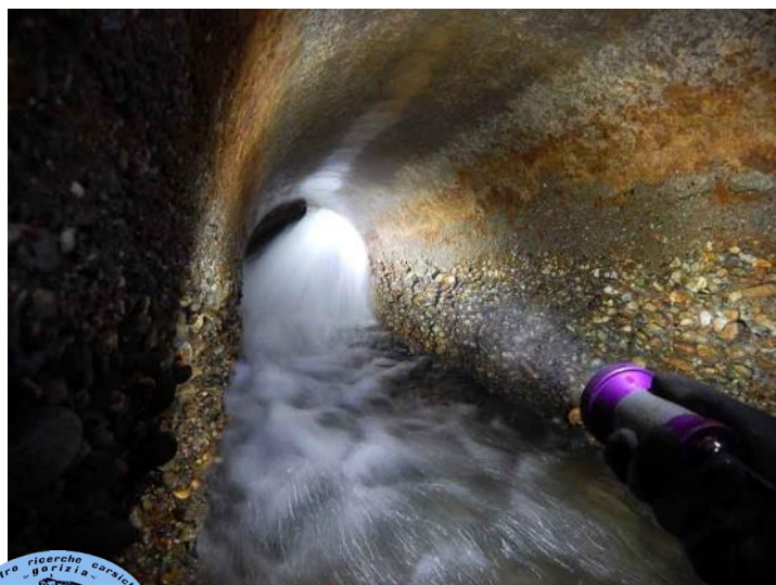
Fig. 69. Acqua proveniente dall'impianto di teleriscaldamento. Qualcheduno ha mai spiegato a taluni personaggi che la forza dell'acqua in pressione può demolire le fondamenta delle strutture antiche?
