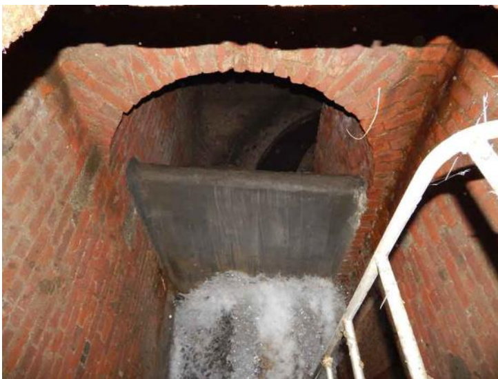
Fig. 67. Punto di confluenza delle acque che imboccano il condotto che le conduce nella fognatura principale. La spalla sinistra reca ancora gli elementi di granito all'interno dei quali andavano a chiudersi i paletti del portone (vedere fig. 68).
