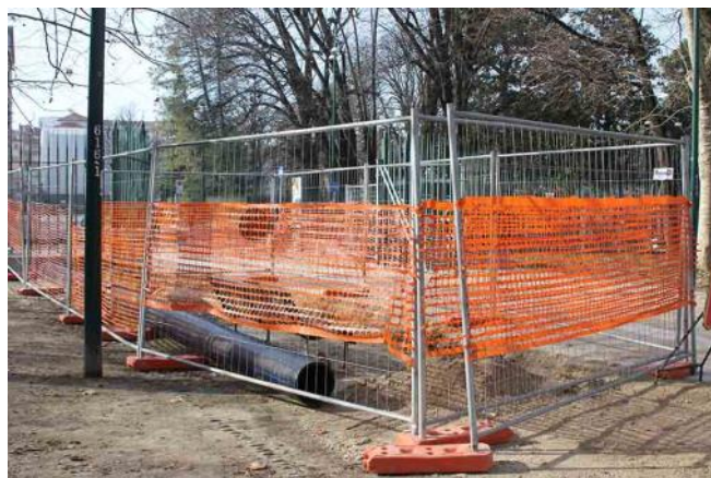
Fig. 74. Preparazione del cantiere per i nuovi scavi che accoglieranno le tubature per le acque reflue del Castello: faranno lo slalom tra le opere del passato parzialmente demolite. Non un cartello informa il Cittadino su cosa si stia facendo.
