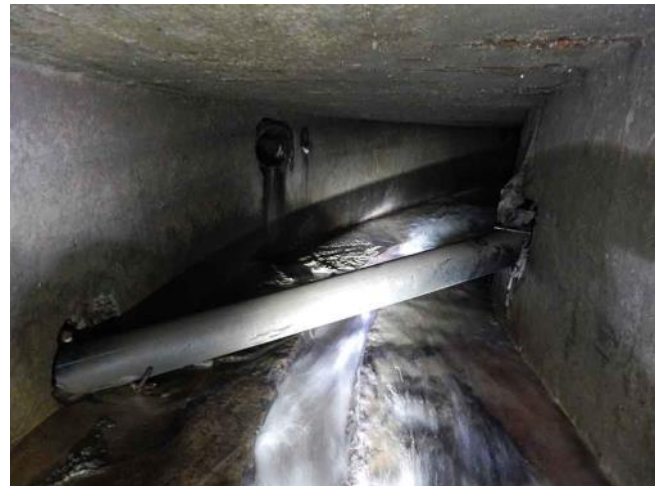
Fig. 58. La moderna fognatura è attraversata, a sua volta, da altri tubi che a detta dei tecnici non dovrebbero esserci.
