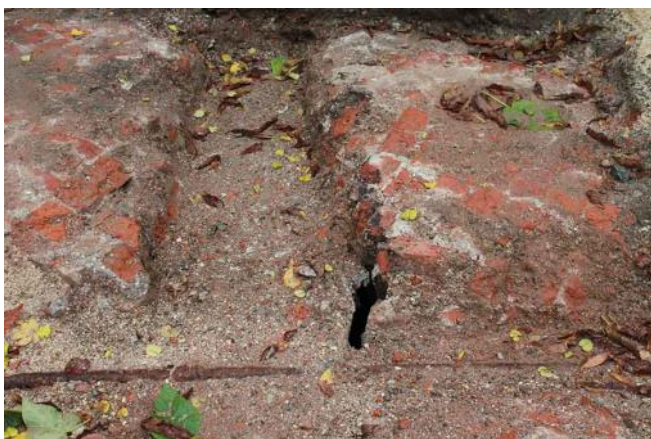
Fig. 79. Ecco il primo "buco" sulla volta della Galleria delle Radici.
