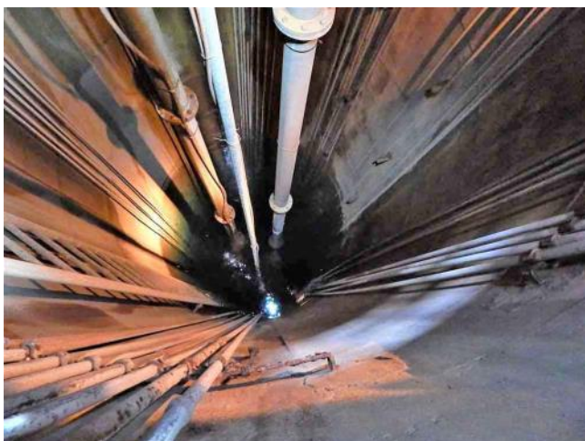
Fig. 94. Pozzo radiale della Centrale di pompaggio Testi.
