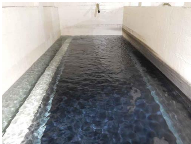
Fig. 99. Una delle vasche della Centrale di pompaggio Padova.
