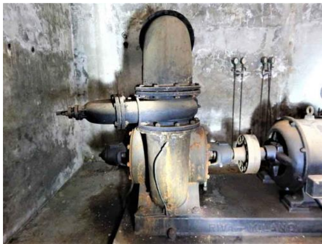
Fig. 108. Impianto idraulico sotterraneo della prima metà del Novecento in Piazza Giulio Cesare.
