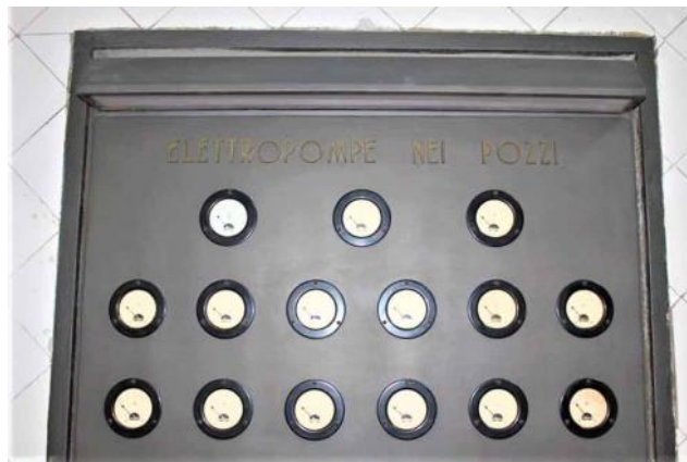
Fig. 53. Quadro d'epoca delle Elettropompe dei Pozzi.
