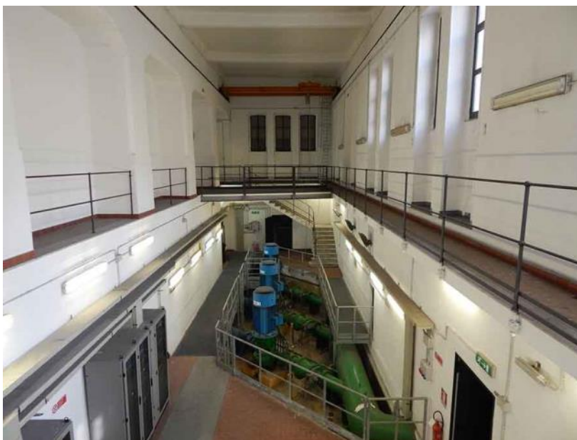
Fig. 46. Interno della Centrale di pompaggio Armi con il moderno impianto d'acquedotto.
