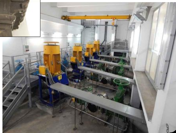
Fig. 58. Interno della Centrale di pompaggio Parco.
