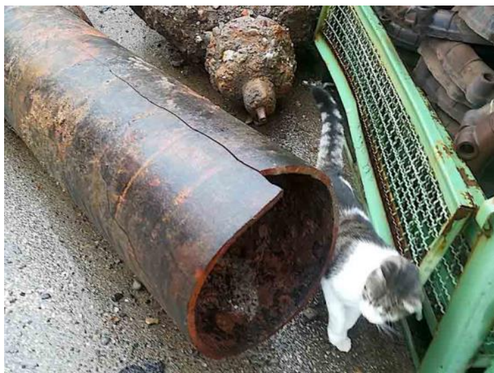
Fig. 104. Particolare di una tubatura d'epoca degradata (foto M. A. Breda).
