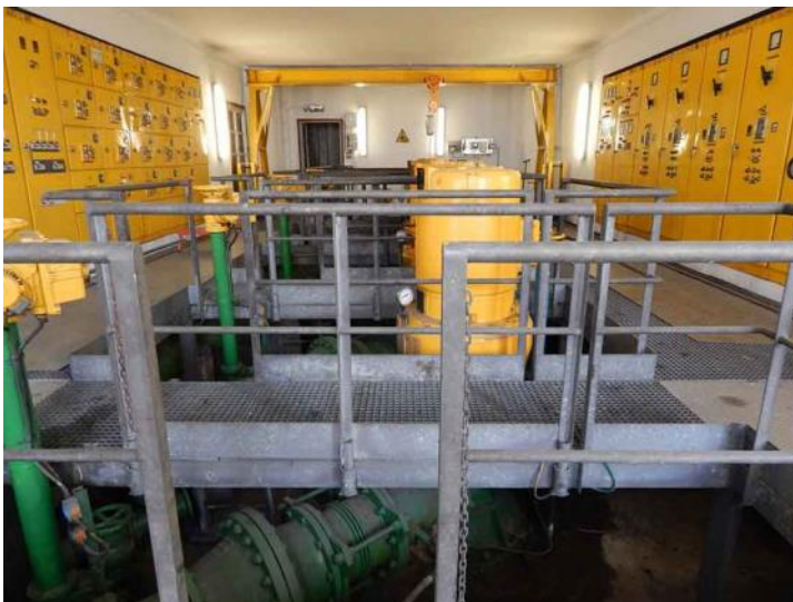
Fig. 85. Interno della Centrale di pompaggio Ovidio ai giorni nostri.
