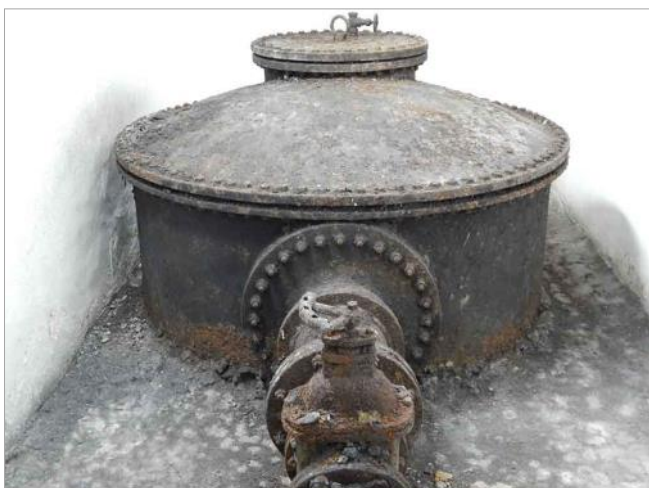
Fig. 47. Pozzo dei primi del XX secolo conservato nella Centrale di pompaggio Armi.
