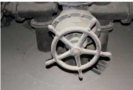
Fig. 35. Torrione Sud: tutto l'impianto idraulico è ancora integro e costituisce uno splendido, ma abbandonato, esempio di archeologia industriale.
