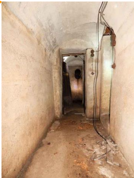
Fig. 63. Corridoio d'accesso al rifugio antiaereo in calcestruzzo della Centrale di pompaggio Ascanio Sforza.
