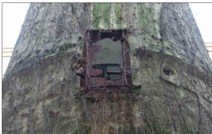
Fig. 57. Della porta antiscoppio che chiudeva l'accesso al terzo piano è rimasto giusto il telaio e poco altro.
