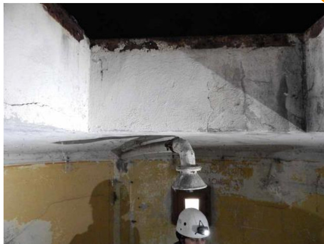
Fig. 56. Sesto piano con al di sopra l'accesso al "sottotetto"; alle spalle della speleologa vi è il foro passante in cui avrebbe dovuto essere alloggiato l'impianto per l'analisi dell'aria. Rimanendone privo, tale foro è stato sigillato con un semplice "finestrino".
