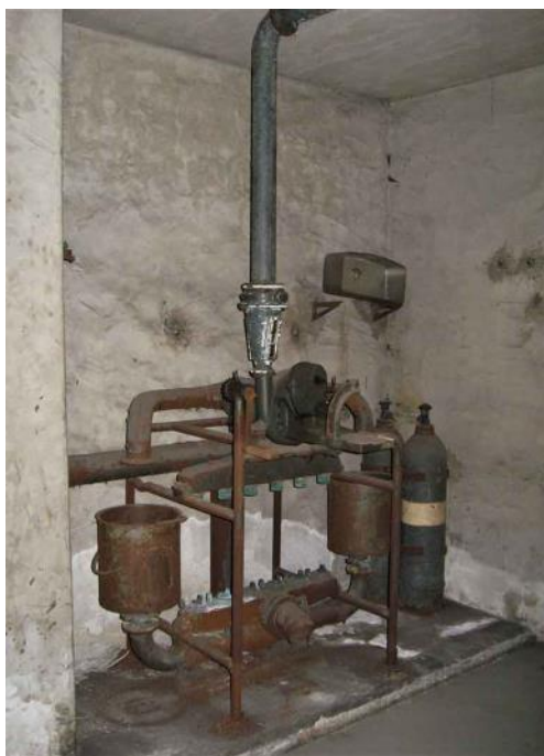
Fig. 8 - Interno del rifugio antiaereo in cemento armato dell'Istituto Virgilio, a Milano in Piazza Ascoli. Si vede chiaramente l'impianto di ventilazione forzata, filtrazione e rigenerazione dell'aria; le due bombole addossate alla parete sono caricate con l'ossigeno, necessario per tramutare l'ambiente da "maschera antigas collettiva" ad "Auto Respiratore a Ossigeno" collettivo.
