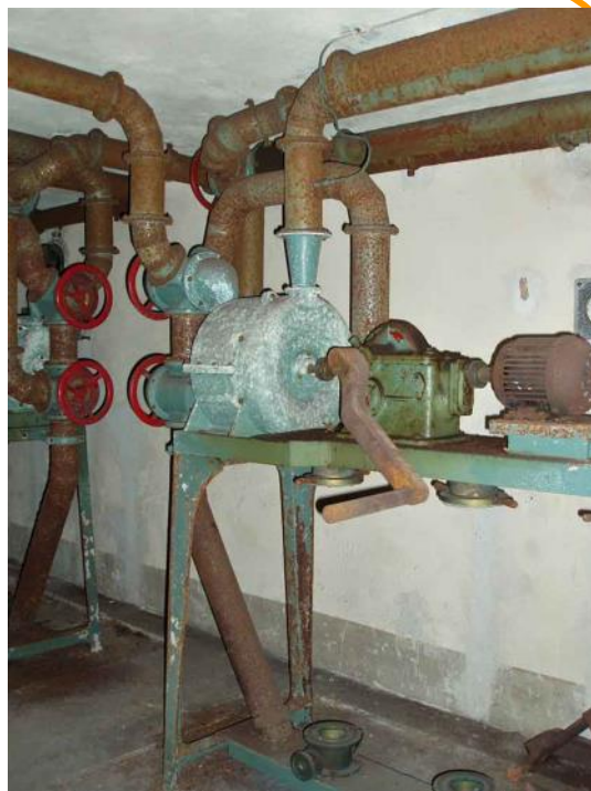
Fig. 10 - Milano, Bunker della Regia Prefettura: in caso di mancata erogazione elettrica la manovella serviva ad azionare la dinamo che manteneva in funzione l'impianto di ventilazione forzata, filtrazione e rigenerazione dell'aria.
