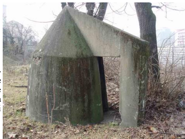
Fig. 50 - Rifugio monopersona in cemento armato ancora presente a Sesto San Giovanni nell'ex Area Falck, il più grande impianto siderurgico lombardo, che nonostante producesse armamenti non venne nemmeno mitragliato, a differenza della vicina Milano, pesantemente bombardata durante tutta la durata del conflitto.
