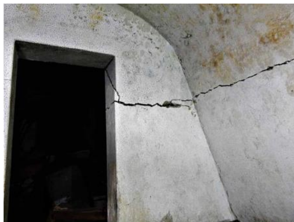
Fig. 1b - Evidente cedimento strutturale, avvenuto per l'assenza dell'armatura, di un lungo tratto del rifugio nel Quartiere Ettore Ponti.
