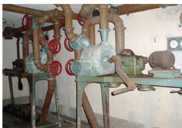
Figura 7. L'impianto di filtrazione e rigenerazione dell'aria del piano semi sotterraneo del Bunker; foto di G. Padovan.
